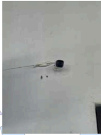
Gambar 11. Hasil pemasangan CCTV
