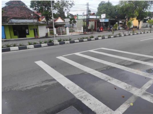
Gambar 26. Kondisi Pita Penggaduh
