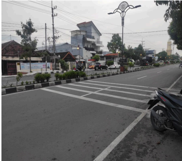
Gambar 24. Kondisi Jalan Empunala
