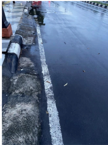
Gambar 25. Kondisi Marka Bahu Jalan
