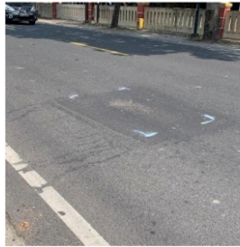
Gambar 2. 3 Kondisi Eksisting Ruas Jalan D.I Panjaitan (Sumber : Penulis 2025)
