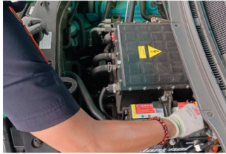
Gambar 33. Memeriksa tanda peringatan listrik
