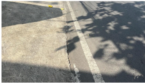
Gambar 11 Visualisasi Bahu Jalan Di Sta 6 Ruas Jalan Sudanco Supriadi Kota Malang
